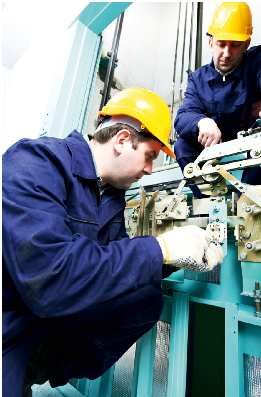
Abbildung 1: Aufzugsmonteure müssen sowohl körperliche Belastungen bewältigen können als auch hohe fachliche Anforderungen auf dem Gebiet der Mechanik und Elektronik beherrschen.
